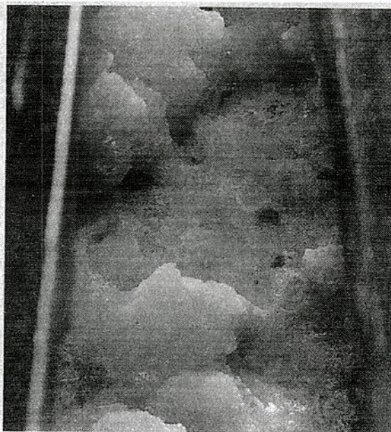
Figura 2: Incrustação carbonato de cálcio no interior de dutos.
